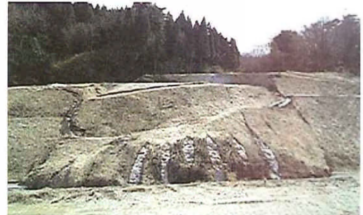
写真:崩壊地の全景
