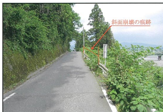
写真1 幅員の部分的な狭まり(斜面崩壊の痕跡)
