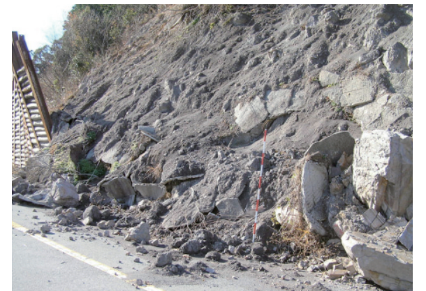
写真:古第三紀層地帯での地滑りに伴う崩壊
