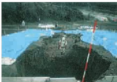
A 盛土崩壊全景
