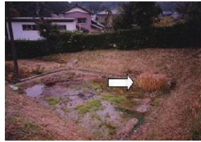
写真1-1 漏水状況(湿地化状態)
