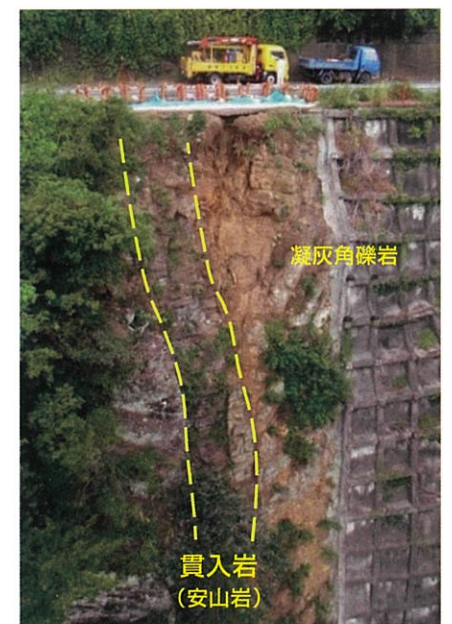
写真-1 被災斜面状況
