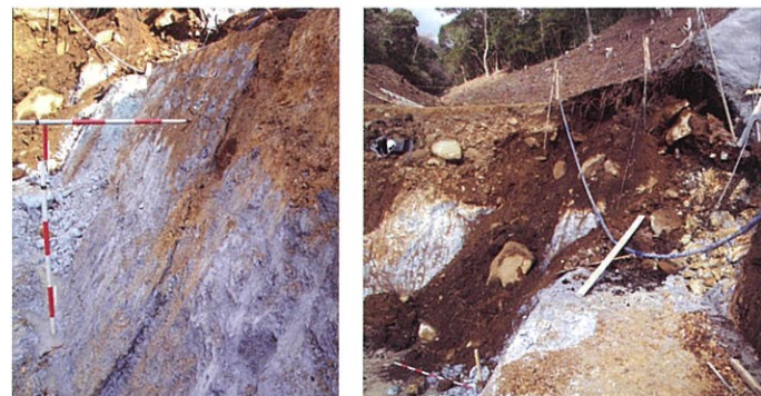
写真.1 孕出しによる切土法面の亀裂 写真.2 掘削時の盤影が崩壊に発展した例
