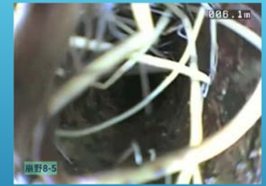
崩野 ⑧-5 深度6mで植物根のため、挿入不能 植物根により閉塞している。
