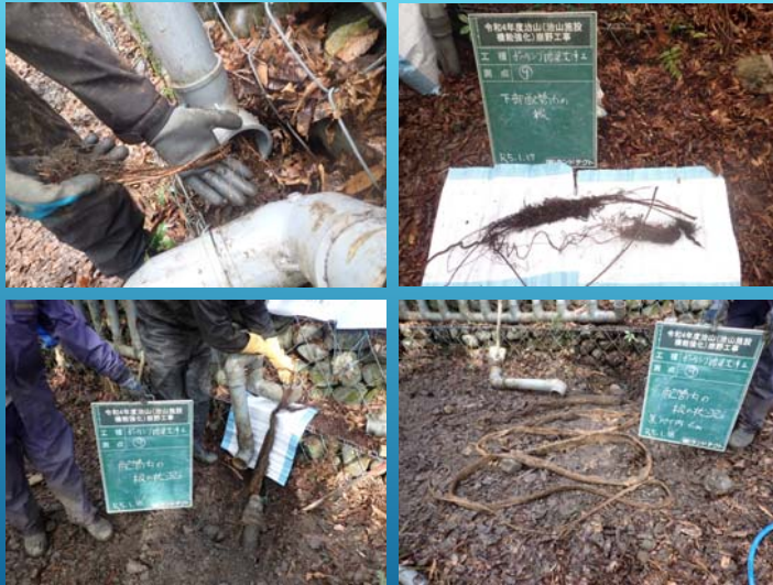
崩野⑨で流末配管内に伸びた植物根の状況
