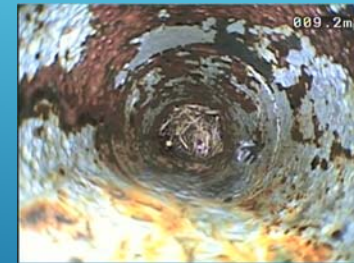
崩野 ⑥-6孔 植物根により閉塞している。
