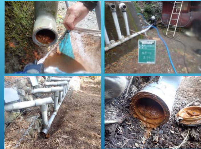
崩野⑦⑧流末配管内のスラッジの状況と洗浄状況
