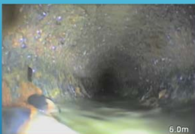
崩野 No.4集水井排水 排水管外から地下水が流入する。
