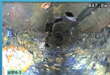
崩野 ⑧-3 先端付近で保孔管が破損
