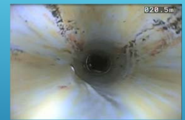
崩野 No.4集水井 上段No.7孔 湧水量が少ない箇所
