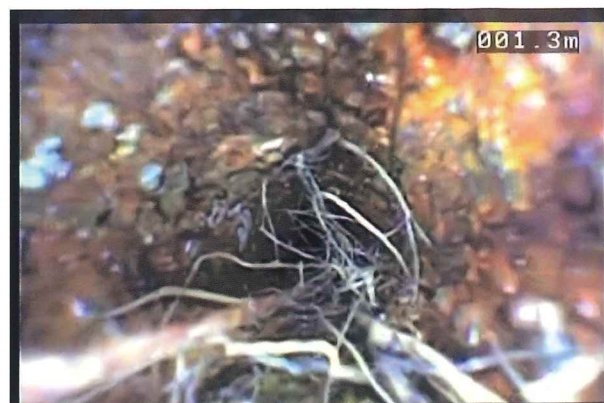
写真-4. 保孔管内に植物の根が伸びている
