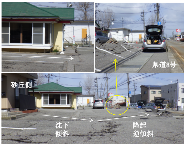
沿道の住宅の隆起例2：鶴ヶ丘2丁目、断面1付近
