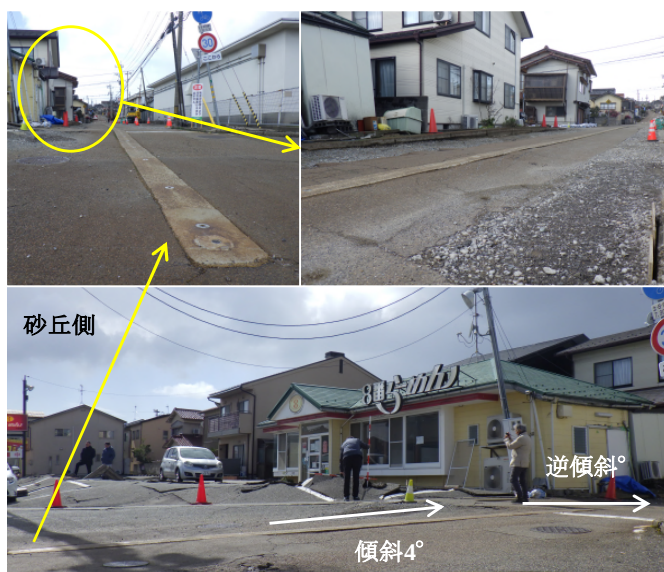
傾斜方向の道路の隆起例1：鶴ヶ丘2丁目、断面1
