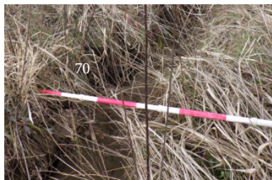
タイプI 亀裂⑥
