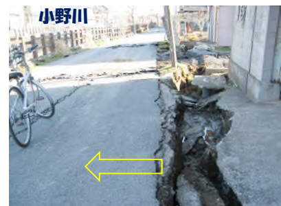
小野川沿いの道路の地盤流動 * 水平変位：数十cm（目測）
