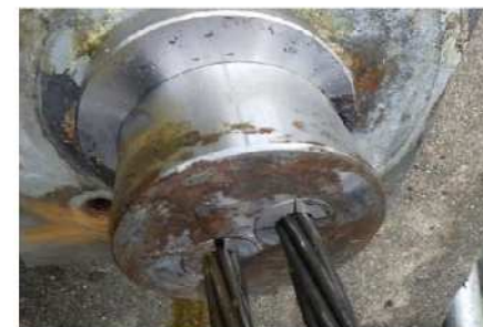
頭部キャップ内に帯水を確認。
