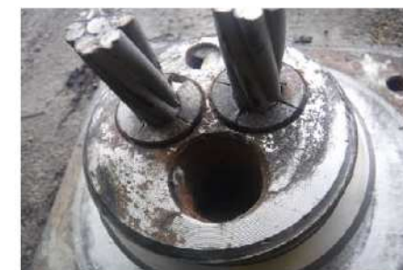
アンカーヘッドに腐食によるやや顕著な錆を確認。
