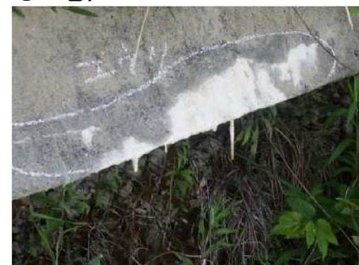
法枠のクラック
