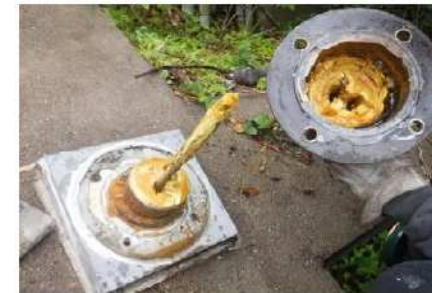
防錆油の量は十分であるが、変色して赤褐色化している。
