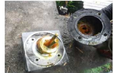
防錆油の量は十分であるが、変色して赤褐色化している。
