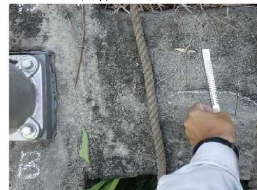
遊離石灰の析出
