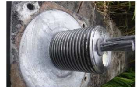
アンカーヘッドに腐食による軽微な錆を確認。
