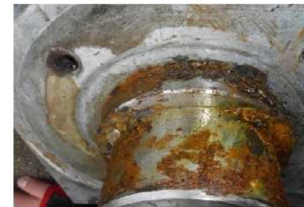
頭部キャップ内に帯水を確認。
