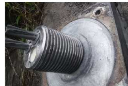
アンカーヘッドに腐食による軽微な錆を確認。
