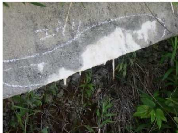
遊離石灰の析出
