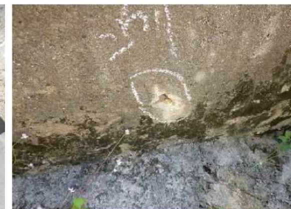
遊離石灰の析出
