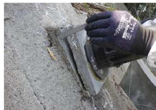
支圧板の浮き
