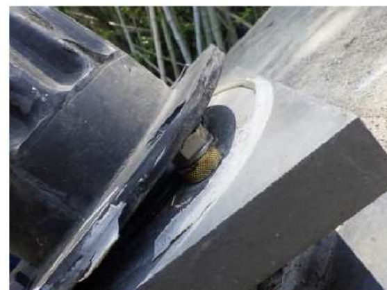
頭部キャップシールの劣化
