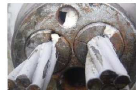
くさびに腐食によるやや顕著な錆を確認。
