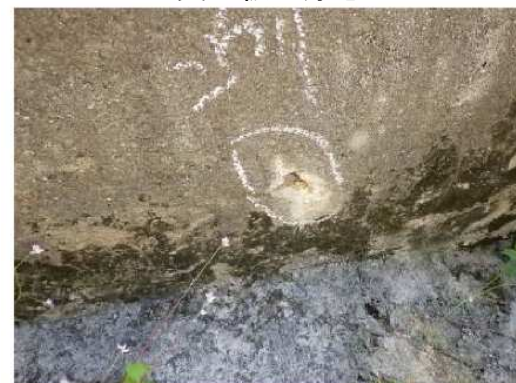
遊離石灰の析出
