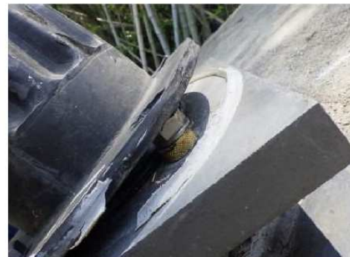
頭部キャップの劣化・破損
