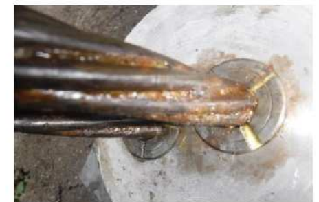
くさび及び鋼線余長に腐食による軽微な錆を確認。
