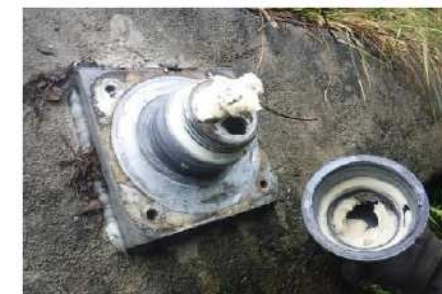
防錆油の量は十分であるが、変色して乳白色化している。
