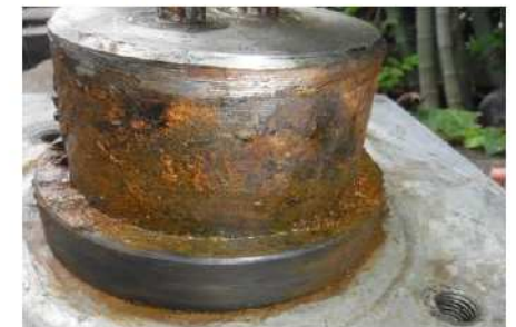
アンカーヘッドに腐食によるやや顕著な錆を確認。
