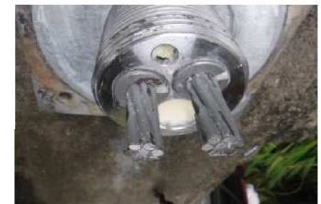
くさびに腐食による軽微な錆を確認。
