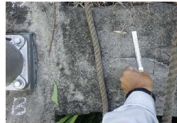
法枠のクラック
