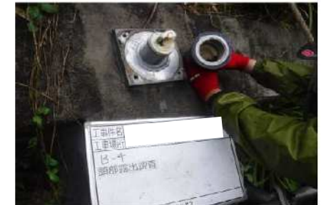
防錆油の量は十分であるが、変色して乳白色化している。
