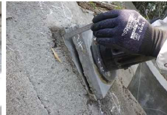
支圧板の浮き
