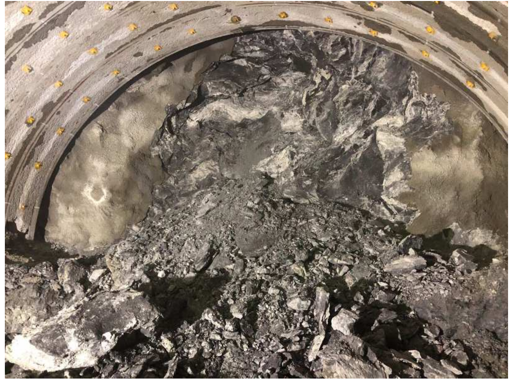
切羽の崩落の状況
